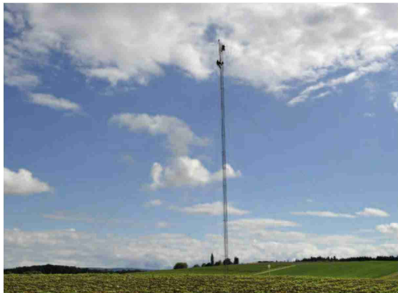
Des monteurs travaillaient, vendredi dernier, à l'édification d'un mât qui devrait accueillir des instruments de mesure.
